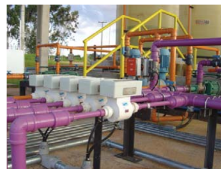
Aplicação do VMS® em linha de dosagem de produtos químicos em ETE da Caesb
