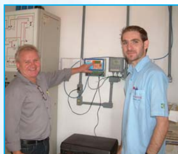
Cliente satisfeito com o serviço da Incontrol e com a solução de seu problema de medição de vazão de efluentes industriais
