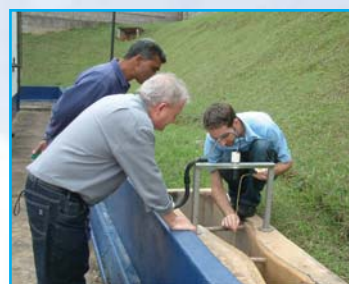
Técnico da Incontrol durante start up de sistema ultrassônico em calha Parshall
